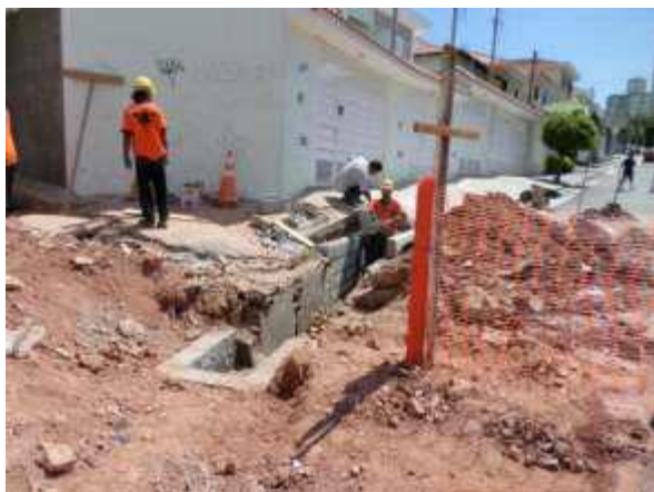
Travessa Neco - Santana/Tucuruvi - antes
